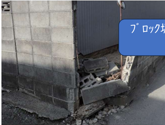
地震によりブロック塀の一部が損壊
