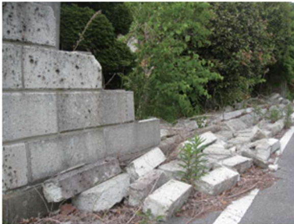
地震により石塀が倒壊
